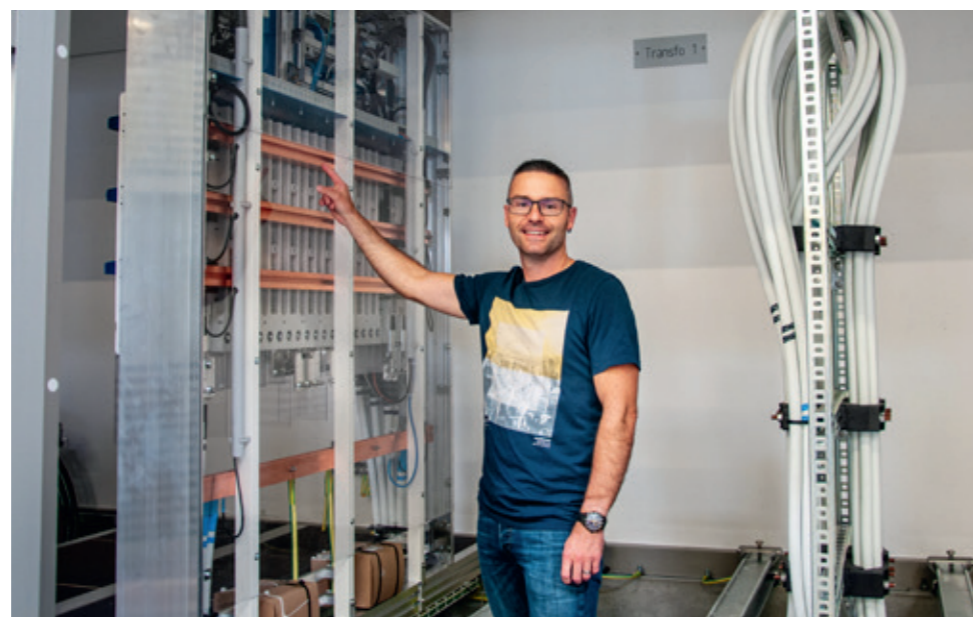
Guido Felder, Projektleiter Innovation / Leiter Umweltmanagement, zeigt das spannende Innenleben einer begehbaren Gebäudestation.
