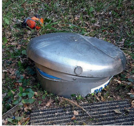
Beschädigter Deckel der Brunnenstube.
