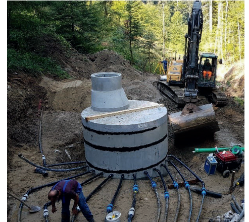
Quelleinläufe werden an die Brunnenstube angeschlossen.
