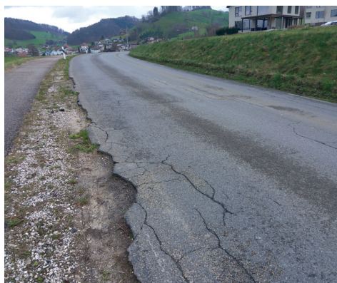
Strassenzustand Dorfstrasse Reidermoos Abschnitt Süd
