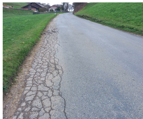
Strassenzustand Dorfstrasse Reidermoos Abschnitt Nord
