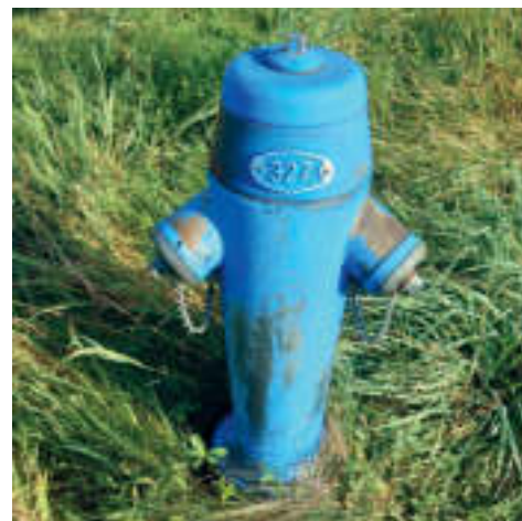
Hydrant Wasserversorgung Langnau
