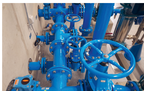
Armaturen Wasserversorgung Reservoir
