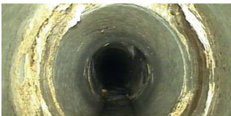
Kanalisation mit Schäden
