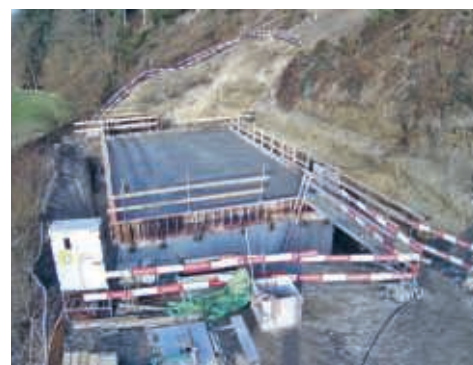
Quellwasserpumpwerk Sagi, Richenthal
