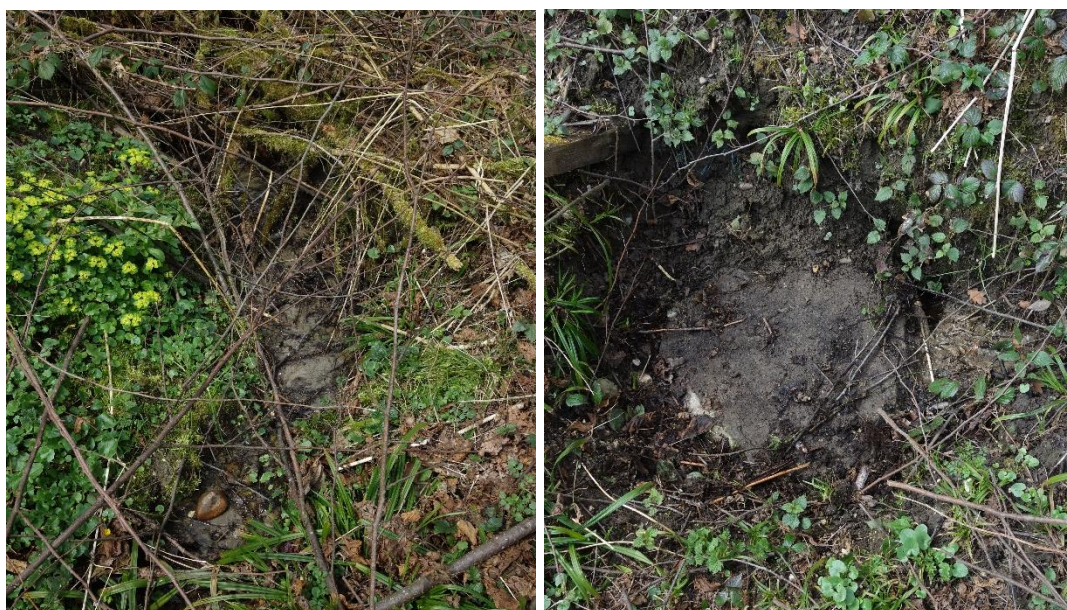
Abbildung 4: links: Hangwasserzufluss unterhalb ehemaliger KD-Box 3 rechts: Einlaufschacht für die Einleitung des Hangwassers in die Eindolung
