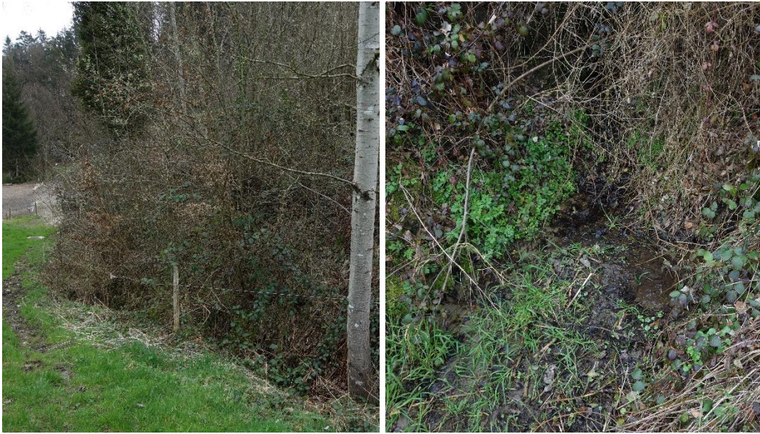
Abbildung 8: links: Steilstrecke entlang der Hecke oberhalb der Eindolung rechts: Sandfang zwischen Durchlass und Eindolung
