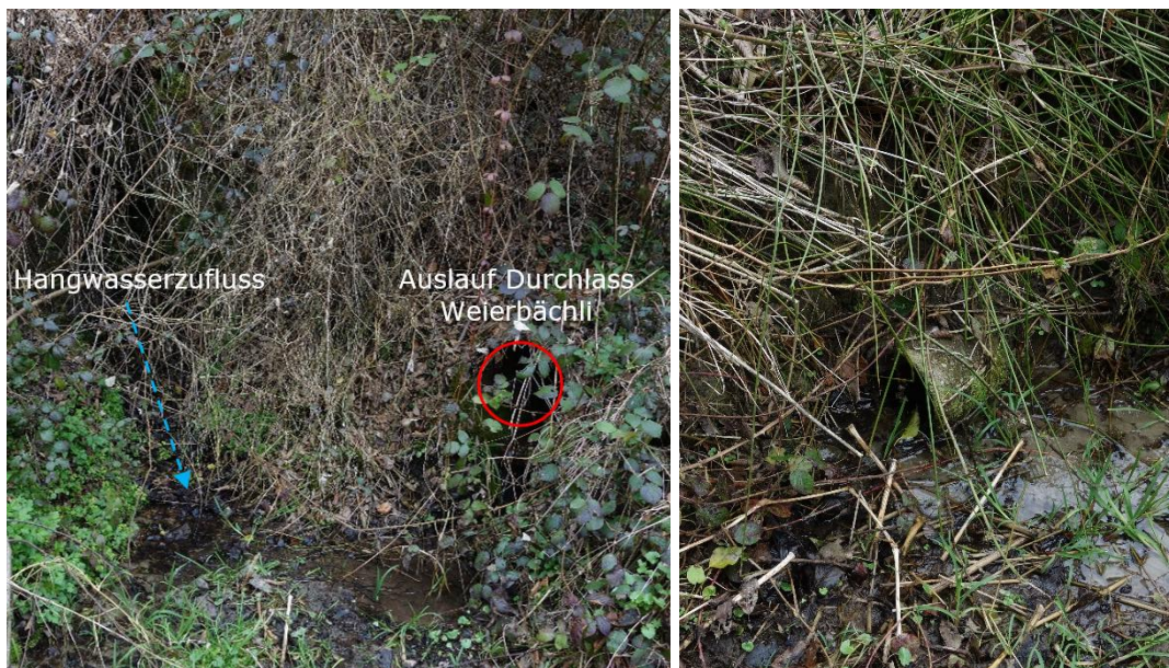
Abbildung 3: rechts: rechtsseitiger Hangwasserzufluss oberhalb ehemaliger KD-Box 3 links: linksseitige Quelleinleitung oberhalb ehemaliger KD-Box 3
