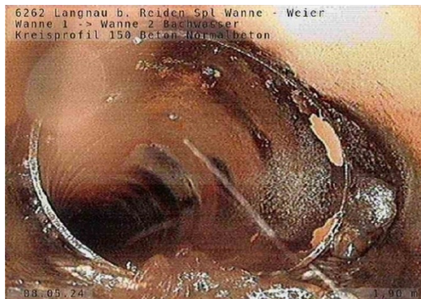
Abb. 6 Infiltration unten und Deformation
